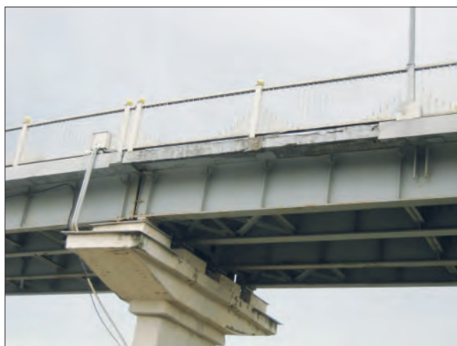
Рис. 5. Шелушение поверхности бетона Fig. 5. Exfoliation of concrete surface
