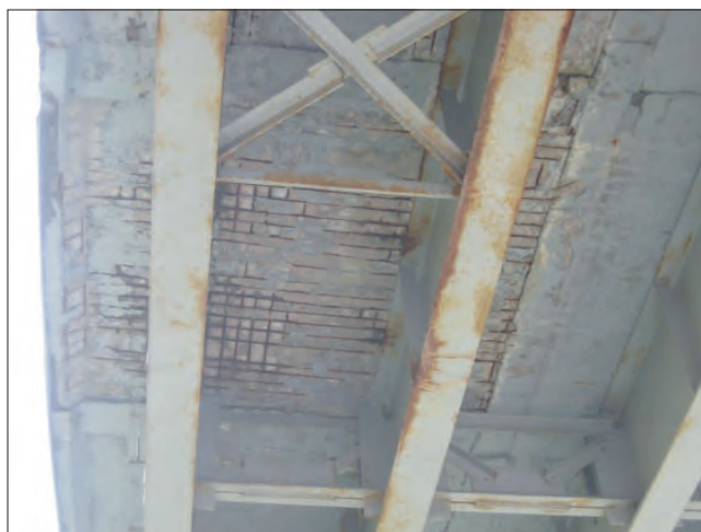
Рис. 3. Дegrадационное разрушение бетона с обнажением и коррозией арматуры Fig. 3. Degradation of concrete with exposure and corrosion of reinforcement
