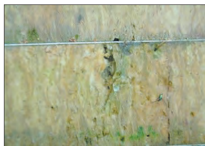
Рис. 2. Биоповреждение теплоизоляционного слоя через полтора года с момента монтажа Fig. 2. Bio-damage of the thermal insulation layer after one and a half years from the moment of installation
