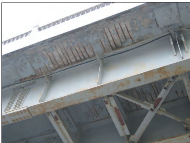
Рис. 2. Разрушение бетона с обнажением и коррозией арматуры Fig. 2. Destruction of concrete with exposure and corrosion of reinforcement
